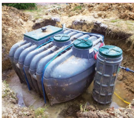
Filtre compact et son poste de relevage
