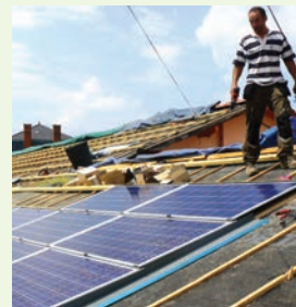
Panneaux photovoltaïques sur toiture
