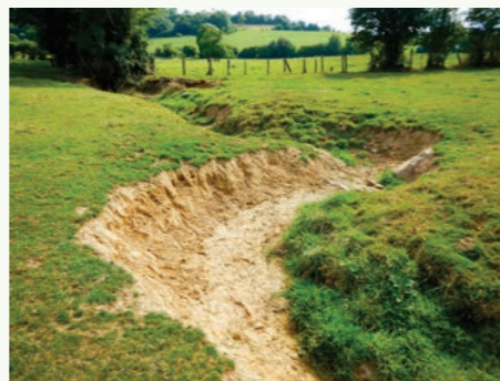
Érosion des berges (ruisseau de la Vallée des Vaux)
